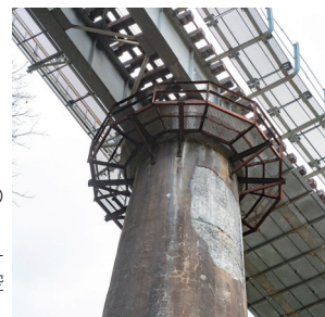
第一小鳥原川橋梁の橋脚 厚さ 40cm のコンクリートを側壁とし、中は空洞になっている。
