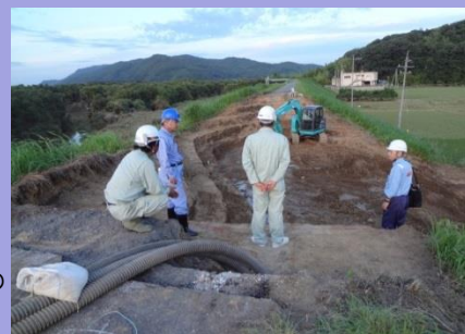
被災現場での打合せ状況
