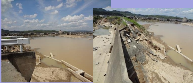
岡山河川事務所管内 高梁川水系小田川被災箇所にて情報収集
