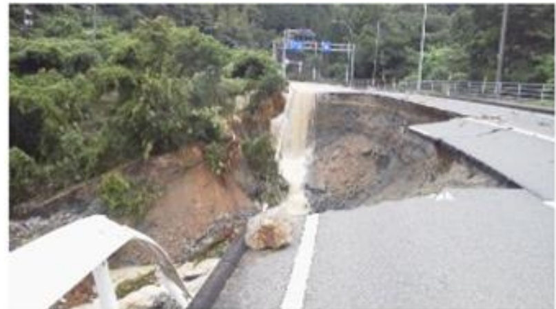
(写真は山口県国道191号線の被害の様子 萩市ホームページより)
